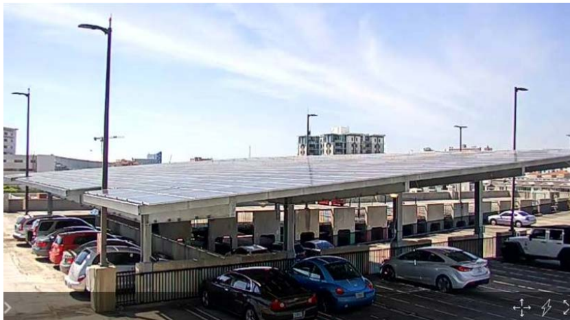
100 kW PV Array
