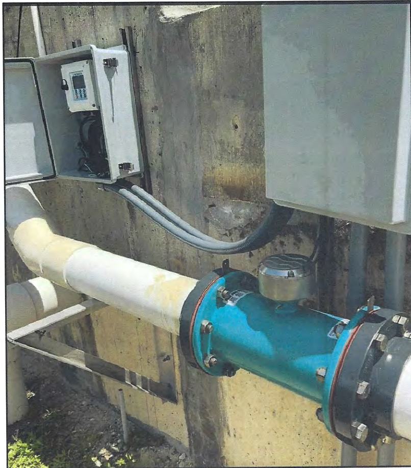
PHOTO 2 EFFLUENT FLOW METER
